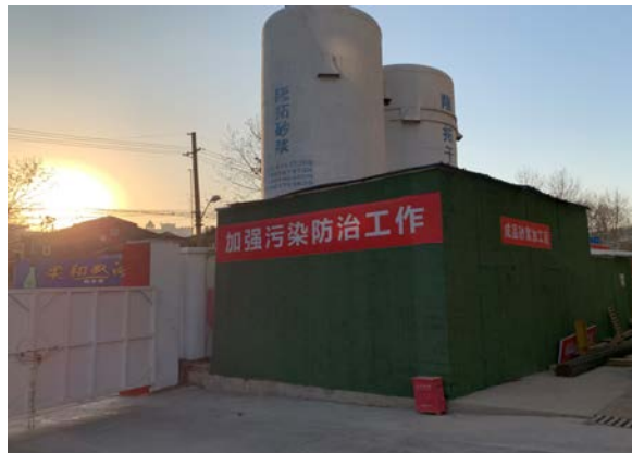
图 21 散装水泥筒仓全封闭
