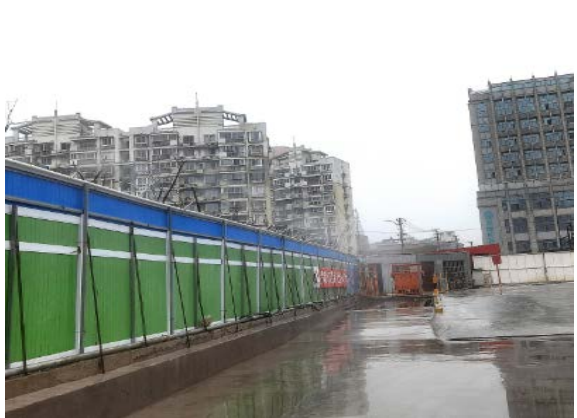
图 18 围墙喷雾降尘装置
